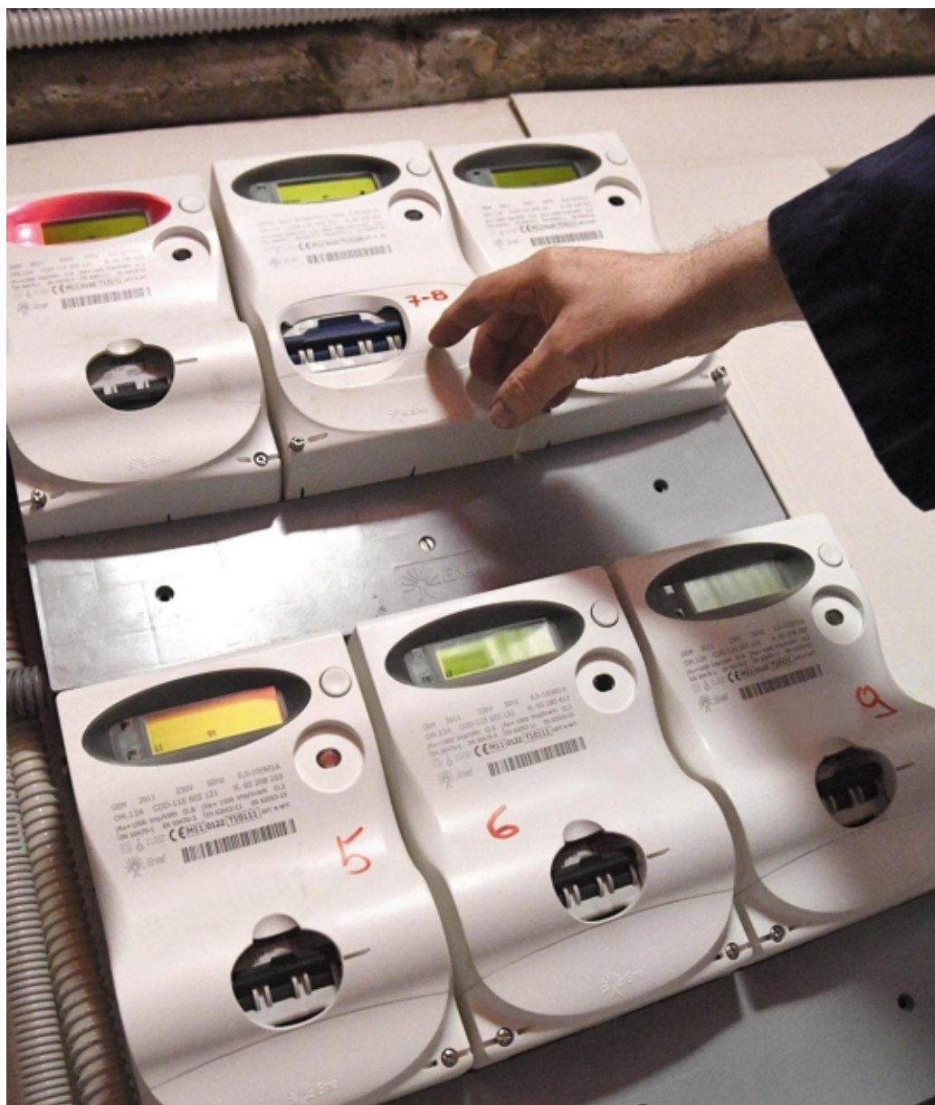
Contatori di energia elettrica in un palazzo ANSA
