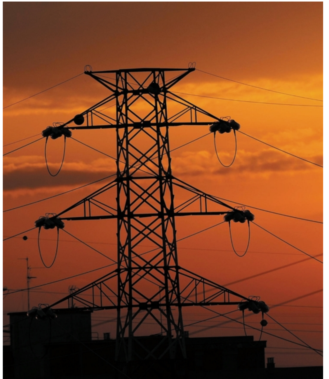
Un traliccio della corrente elettrica ANSA
