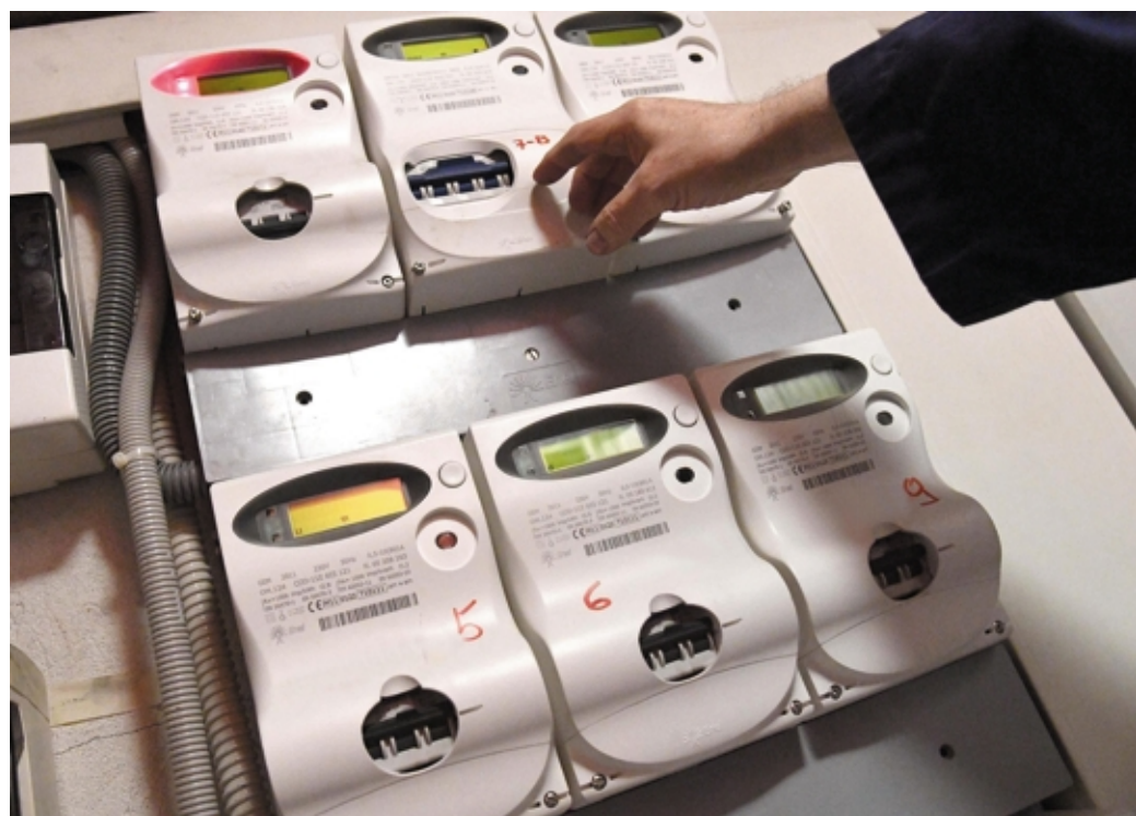
Alcuni contatori di energia elettrica
