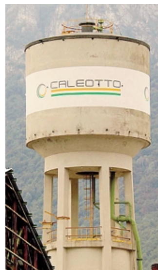
Il serbatoio dell'acqua
