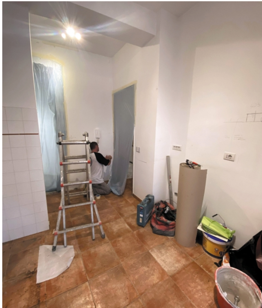
Un operaio al lavoro durante una fase della ristrutturazione di un appartamento ANSA
