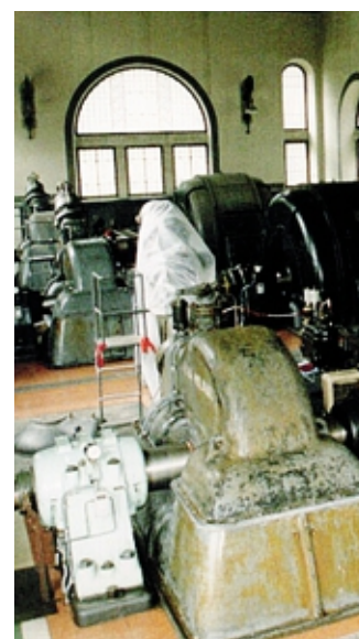
Una centrale idroelettrica
