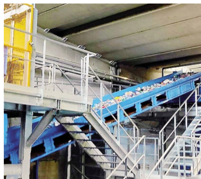
L'innovativo impianto Seruso a Verderio per il recupero della plastica
